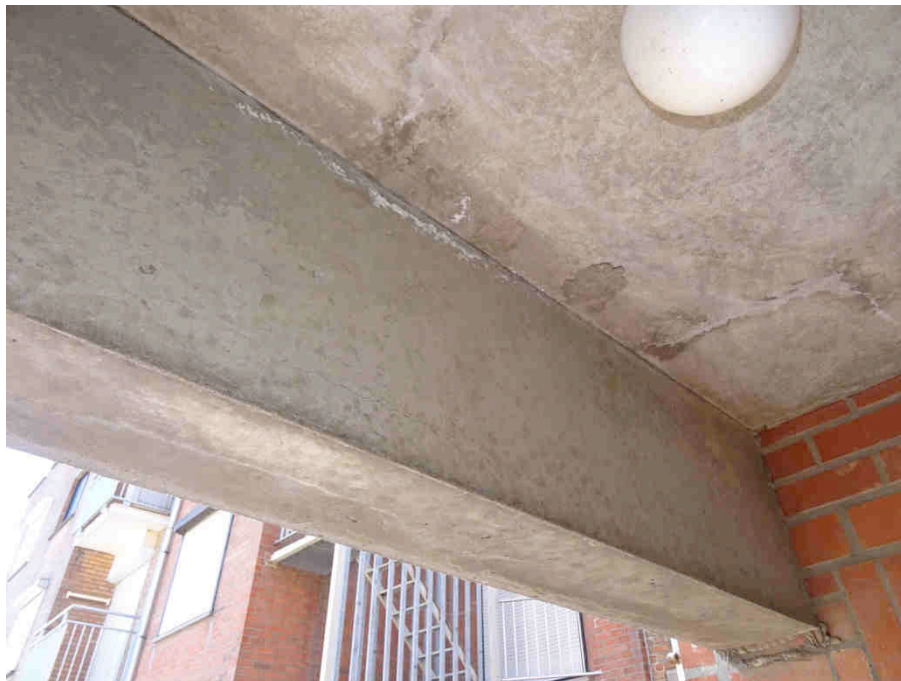
FOTO 13. Residentie ANITA, achtergevel : Detailzicht (foto 11) met schadebeeld balkonneus en gevelbalk (achter- en onderzijde). Eveneens beperkt schadebeeld op balkonhemel.
