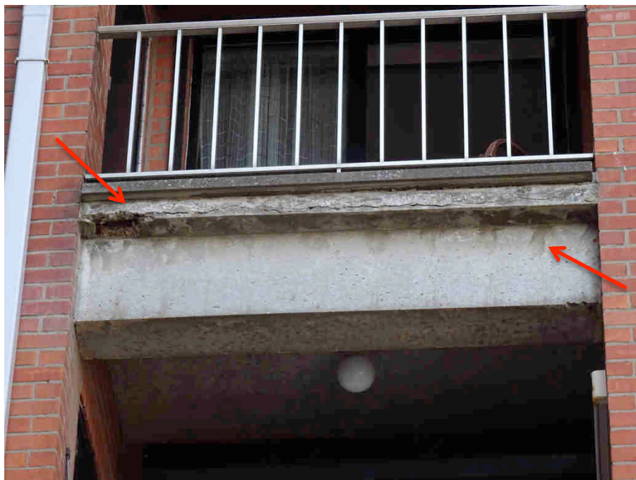
FOTO 9. Residentie ANITA, achtergevel : Detailzicht op schadebeeld balkonneus en gevelbalk.
