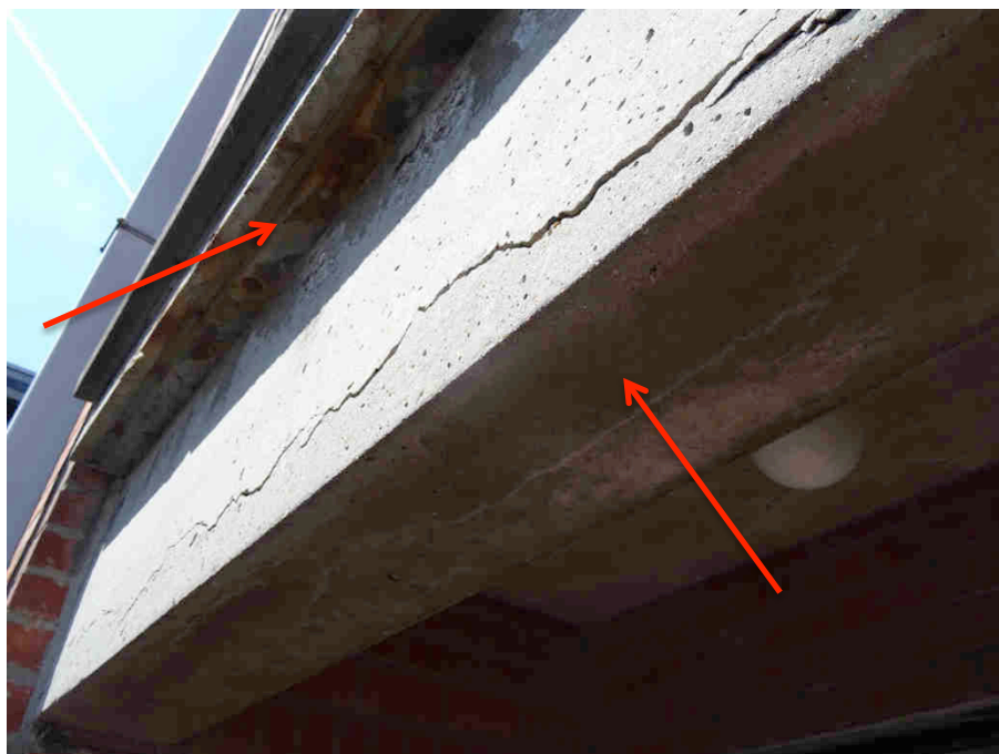
FOTO 12. Residentie ANITA, achtergevel : Detailzicht (foto 11) met schadebeeld balkonneus en gevelbalk (voor- en onderzijde)
