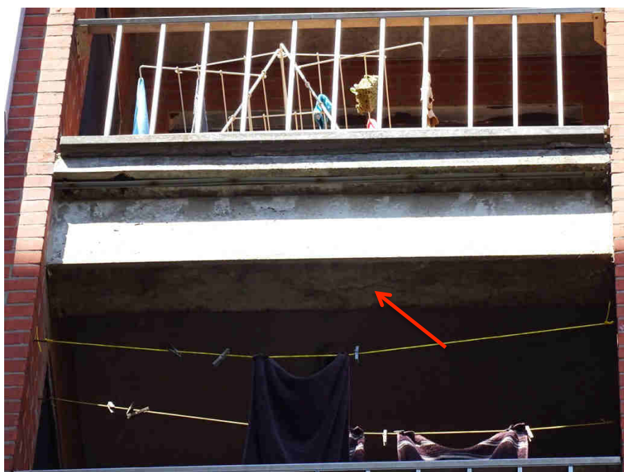
FOTO 10. Residentie ANITA, achtergevel : Detailzicht op schadebeeld balkonneus en gevelbalk.
