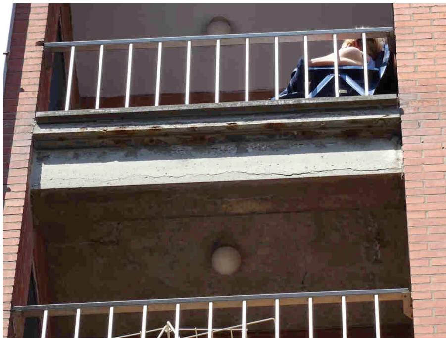
FOTO 11. Residentie ANITA, achtergevel : Detailzicht op schadebeeld balkonneus en gevelbalk.
