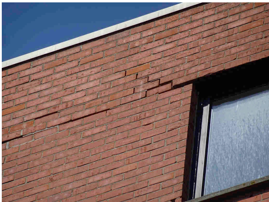
FOTO 19. Residentie ANITA, achtergevel : Detailzicht op corroderend lateiprofiel en zware schade aan gevelmetselwerk. Opdrukking van het metselwerk.
