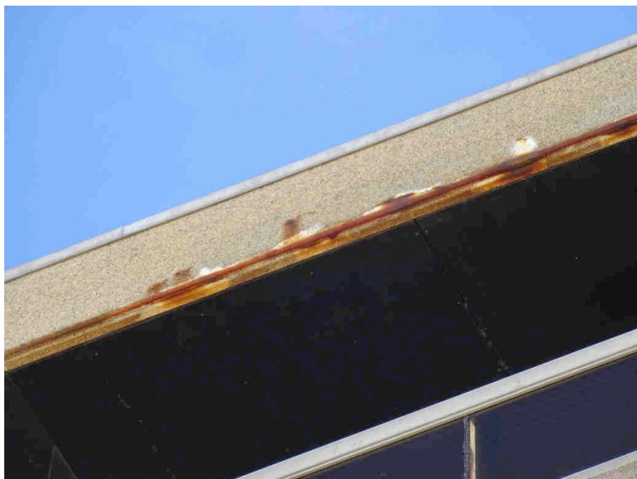
FOTO 4. Residentie ANITA, voorgevel : Idem, detail van frontpaneel dakluifel met specifiek schadebeeld.
