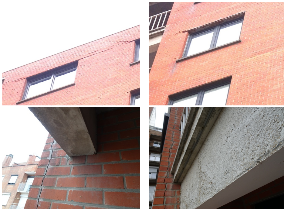
CiBO | Residentie ANITA Scheurvorming in buitenparement achtergevel.
