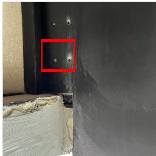
aansluitpunt wachtbuis fiber
