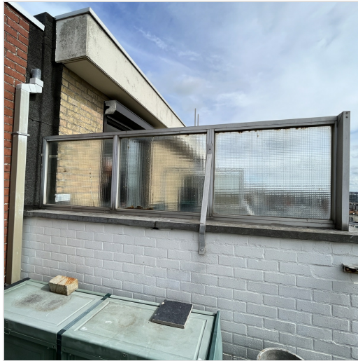
gebarsten draadglas achtergevel app 1002
