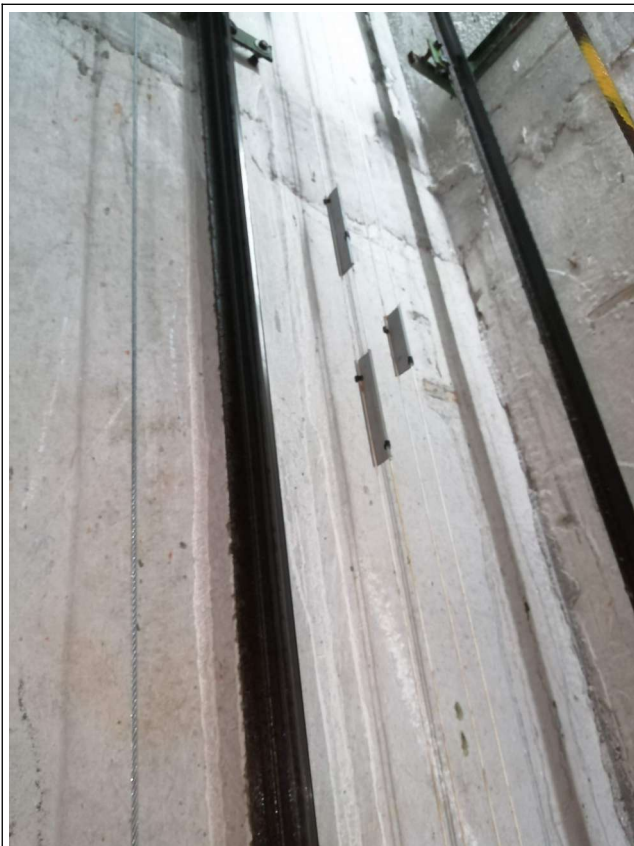
De positievlaggen in de liftschacht kun je verplaatsen om het afrempunt te veranderen.
