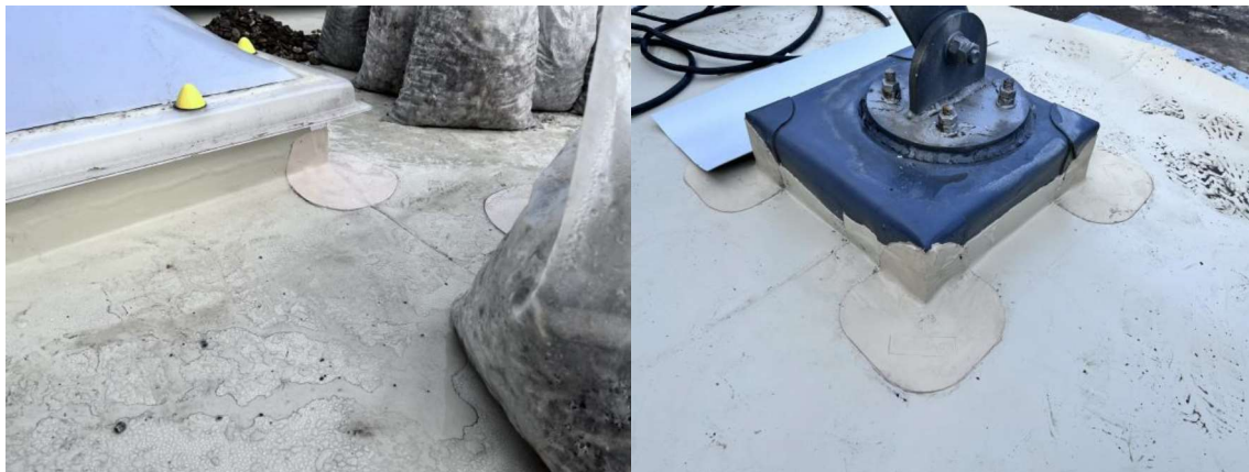
De dakbedekking bestaat uit een losliggend pvc-membraan waarvan de naden worden gelast, op de hoeken worden passtukken gezet ...
