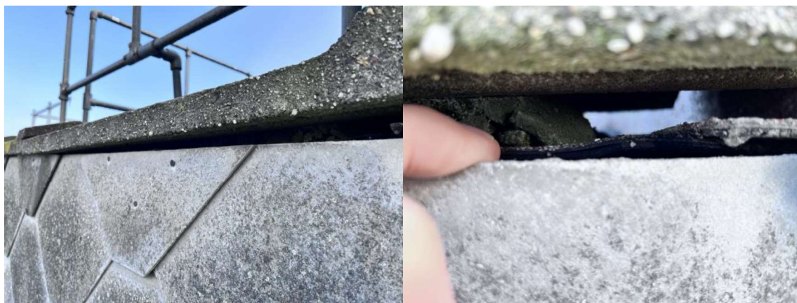
Foute afwerking bij aansluiting op belendend gebouw ...
