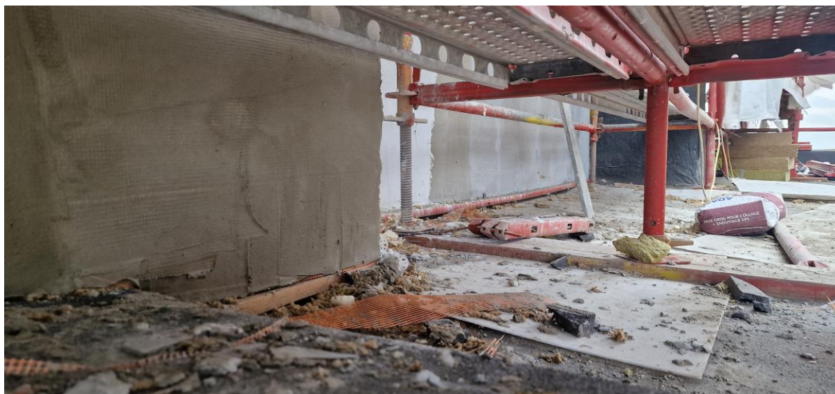
Geen startprofielen geplaatst
