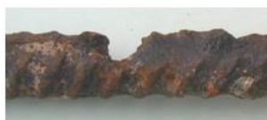
Afb. 1 Putcorrosie door chloriden.
