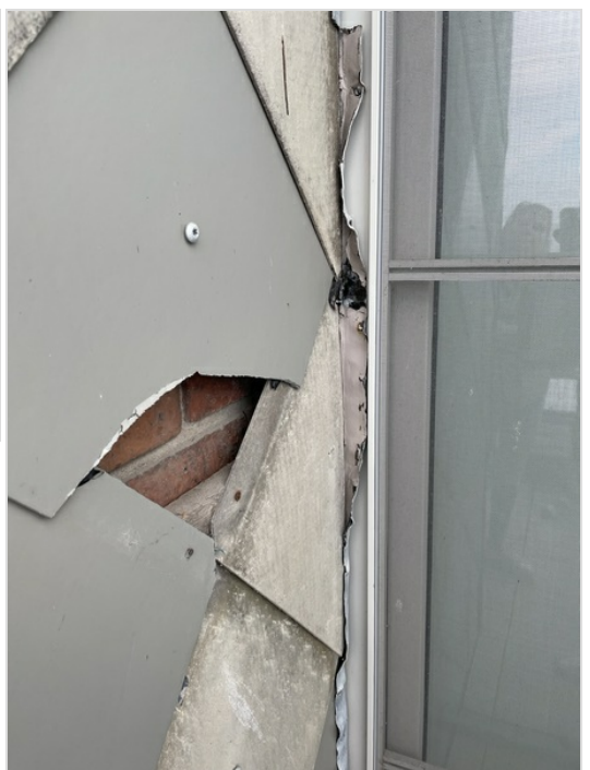
bepaalde ruimte beschikbaar voor isolatie
