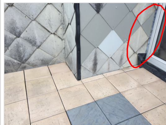
bepaalde ruimte beschikbaar voor isolatie
