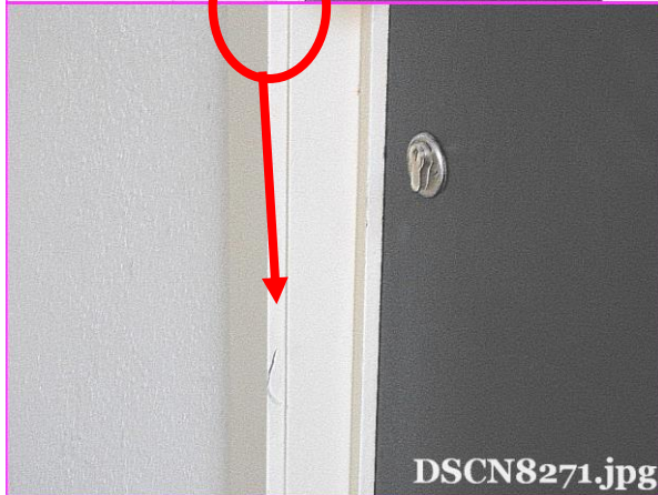
Deur appartement 10C: kleine beschadiging in het verfwerk van de deuromlijsting.
