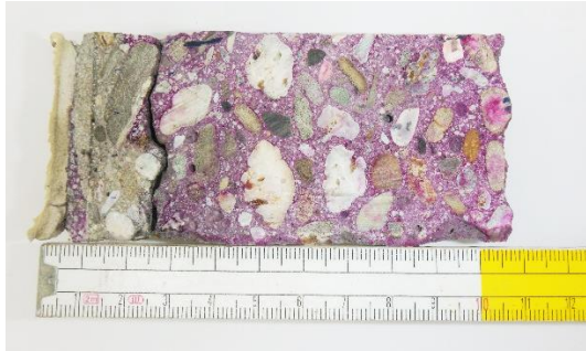
Figuur 32 - carbonatatie diepte kern 1
