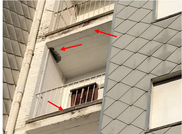
Figuur 15 - afgedrukt beton en vertering, achtergevel, niveau +5 en +6
