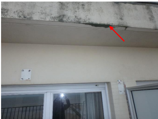
Figuur 4 – Mosgroei en verwering, locatie K6a/b, niveau +7
