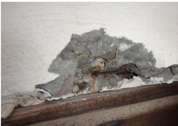
Figuur 12 - Afgedrukt beton en roestvorming onderzijde linteel, locatie B5, niveau +1
