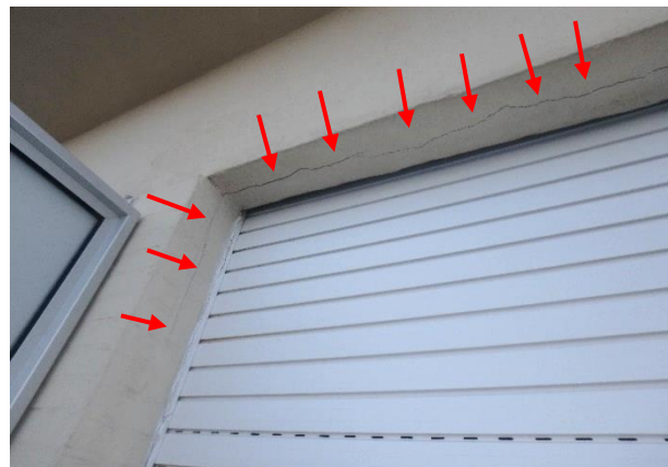
Figuur 13 - Scheurvorming t.p.v. raamopening locatie K1, niveau +7
