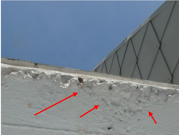
Figuur 14 – Grindnesten, achtergevel
