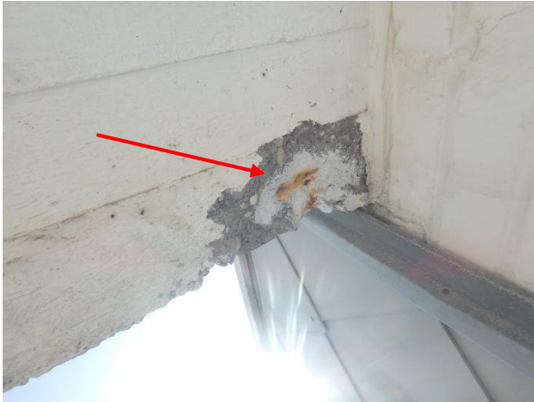
Figuur 8 - afgedrukt beton en roestvorming, locatie K5, niveau +7
