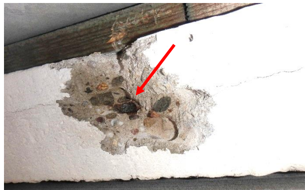
Figuur 39 – Weggebroken beton tot aan de wapening, besprenkeld met fenolftaleïne (locatie B5)
