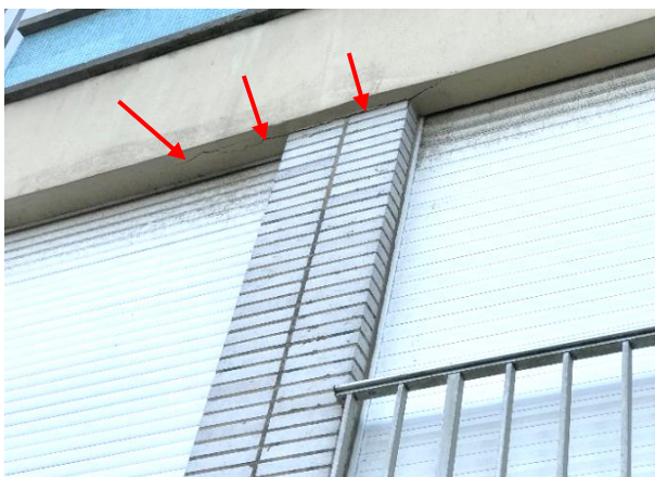
Figuur 6 - scheurvorming onderzijde linteel, locatie B2, niveau +1
