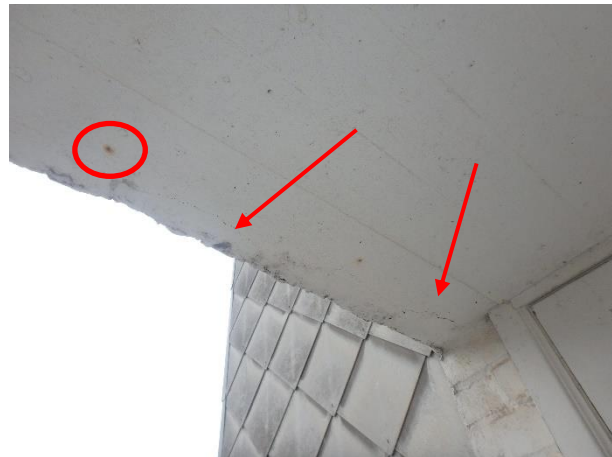
Figuur 11 - roestvlekken en grindnesten, locatie K4, niveau +2
