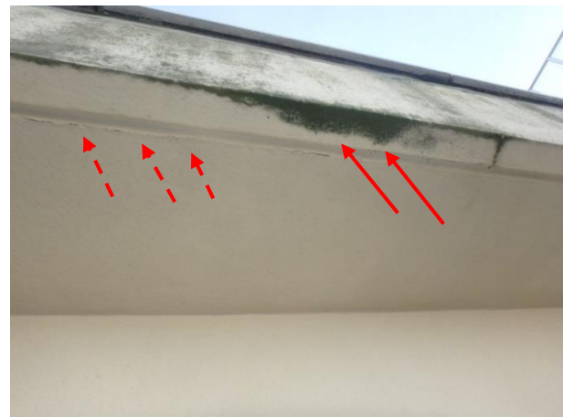
Figuur 5 - verwering en scheurvorming, locatie B1, K1, niveau +7
