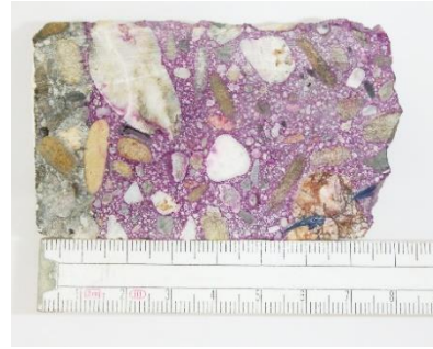
Figuur 33 - carbonatatie diepte kern 2
