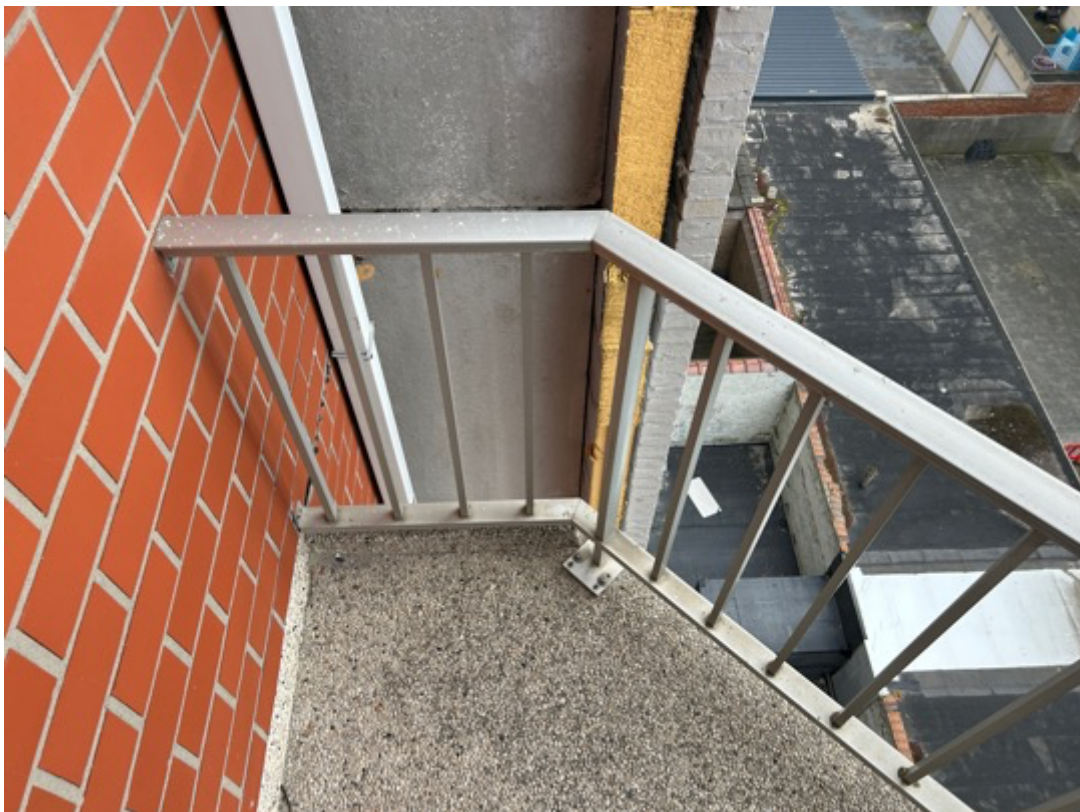
Foto 4: Appartement bus 702, bevuiling balustrade achteraan
