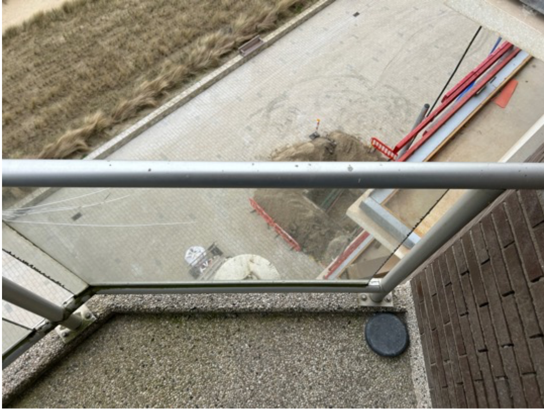
Foto 3: Appartement bus 702, bevuiling balustrade vooraan
