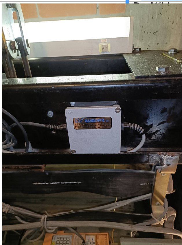
Origineel was een "lastweging" verplicht. Deze is blijkbaar defect en werd door Cosmolift buiten werking gesteld.
